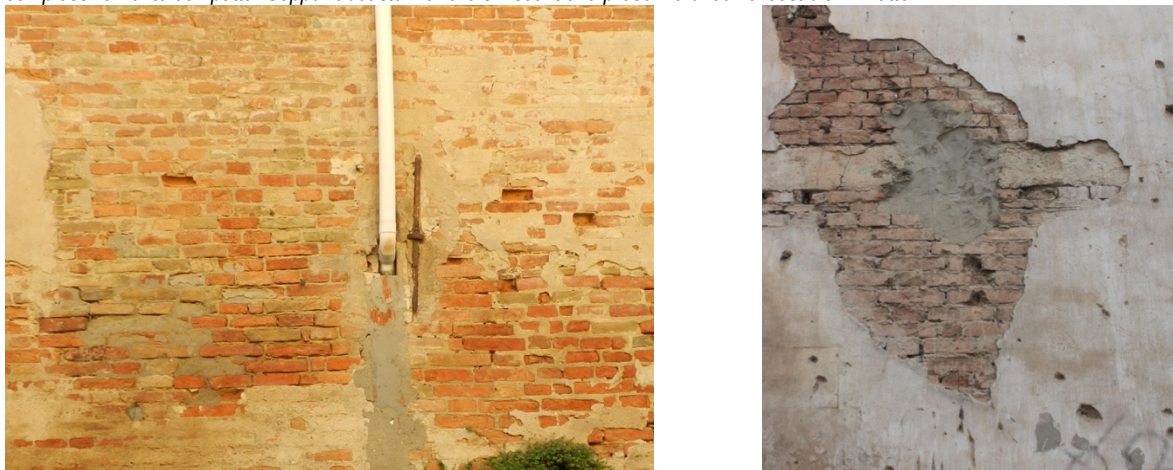
Figura 4 – Murature Castel Bolognese. Le tessiture murarie più frequenti sono realizzate in laterizio considerando il consistente spessore delle murature si presuppone una sezione a tre o a quattro teste. Sul paramento esterno non si riscontra una regola rigorosa nella disposizione dei filari, i quali presentano alternativamente elementi disposti di testa o di fascia. Si rilevano elementi lapidei inseriti all'interno dei paramenti murari.
